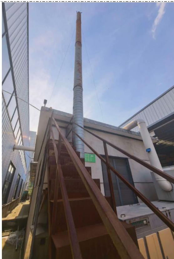
DA001 废气排放口规范化建设
