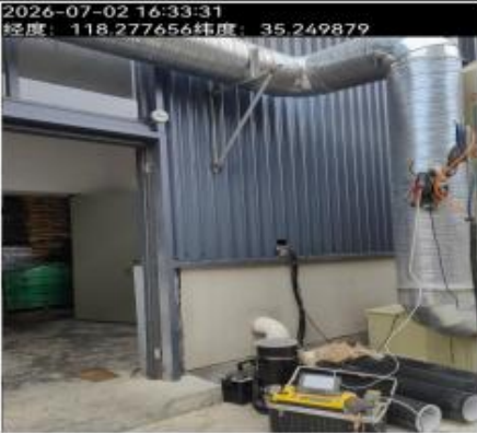
图5 2#车间东挤出工序进口
