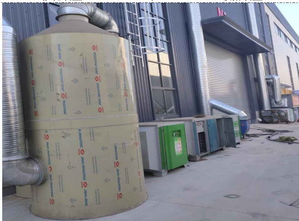
DA003 水喷淋+静电除油+光氧催化+活性炭吸附装置
