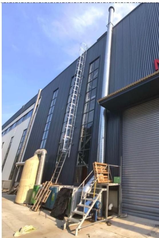
DA003 废气排放口规范化建设
