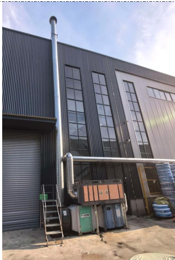
DA002 废气排放口规范化建设
