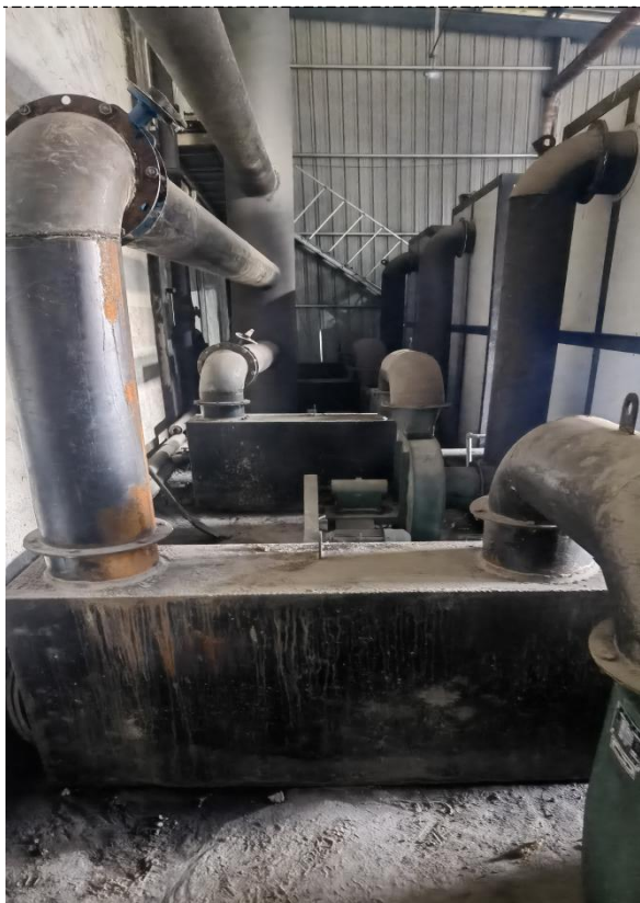
图 4-1 生物质蒸汽发生器燃烧废气处理设施
