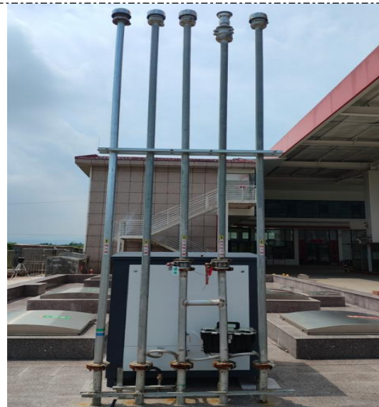
汽油废气排放口及罐区安全阀管
