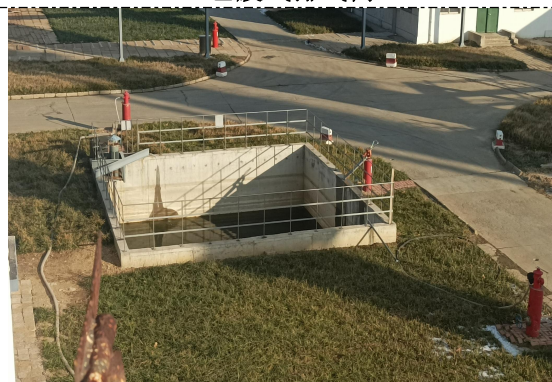
应急事故水池
