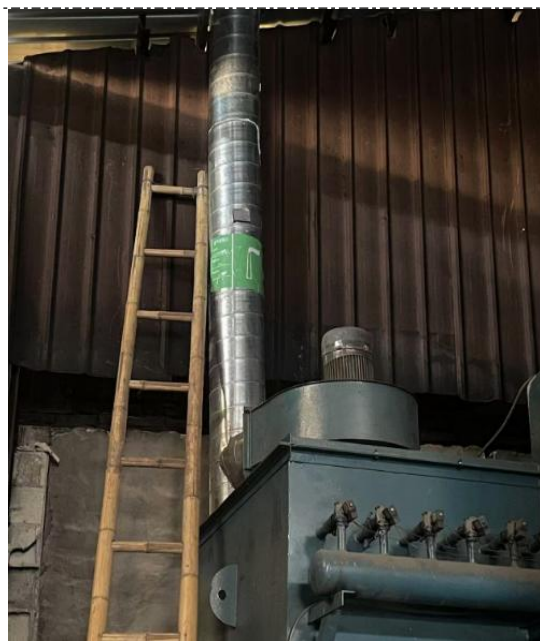
喷砂工序废气排放口规范化建设
