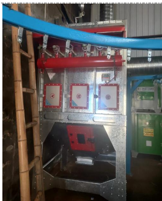
喷塑工序脉冲布袋除尘器
