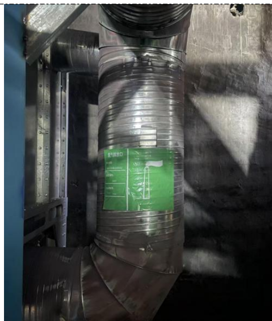
喷塑工序废气排放口规范化建设
