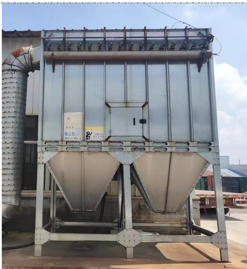
工程机械座椅装配生产工序生产废气处理设施 (脉冲布袋除尘器)
