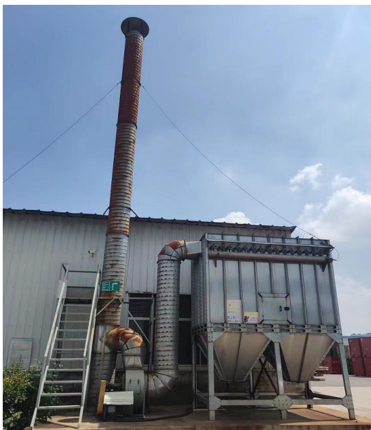
工程机械座椅装配生产工序废气排放 口规范化建设
