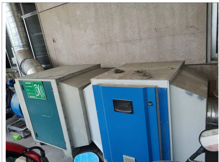
热压工序环保设施
