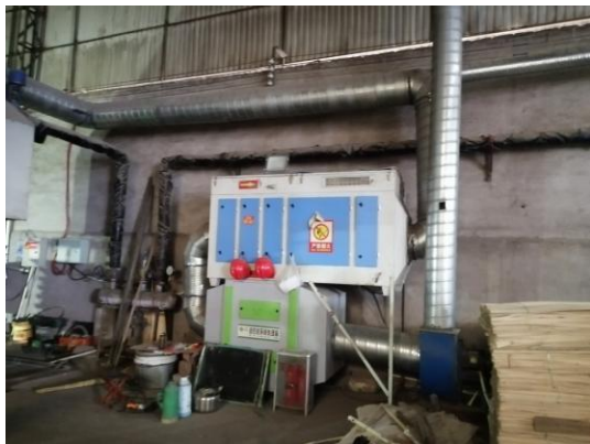
涂胶、热压工序环保设施
