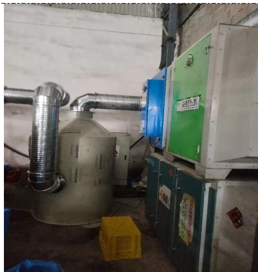
图 4-2 注塑废气处理设施
