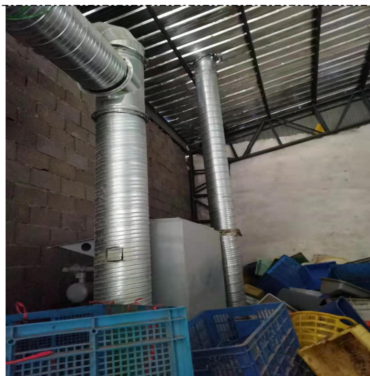
图 4-4 搅拌工序废气处理设施
