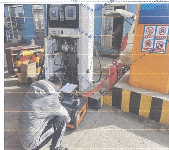
图 3: 二级油气回收检测
