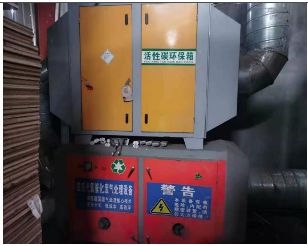
拌胶、涂胶、热压废气处理设备
