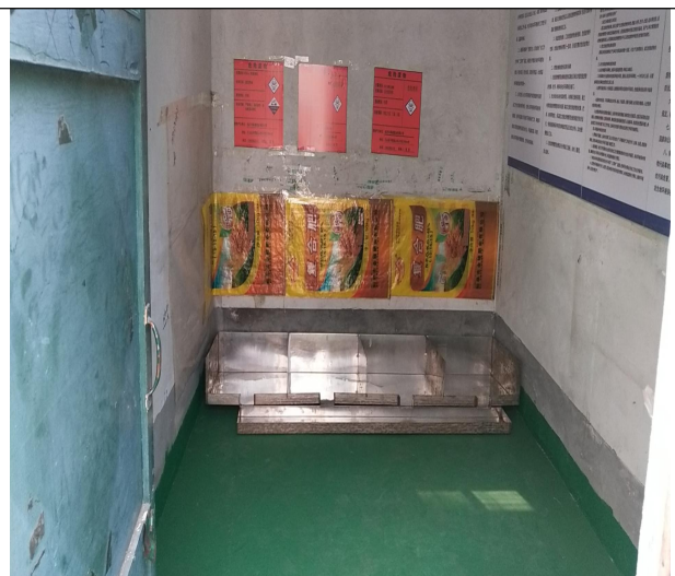
危废库内部分区及防渗
