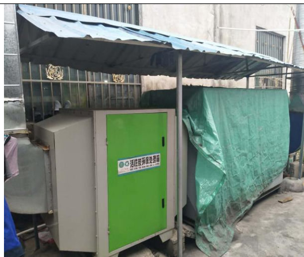
废气处理设施
