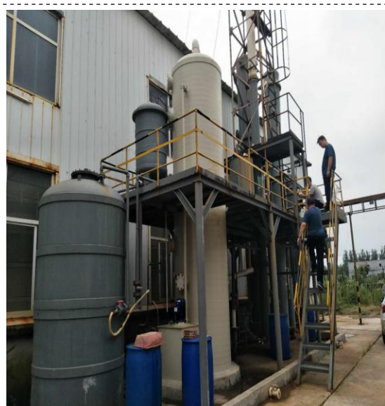
图 4-3 废气处理装置
