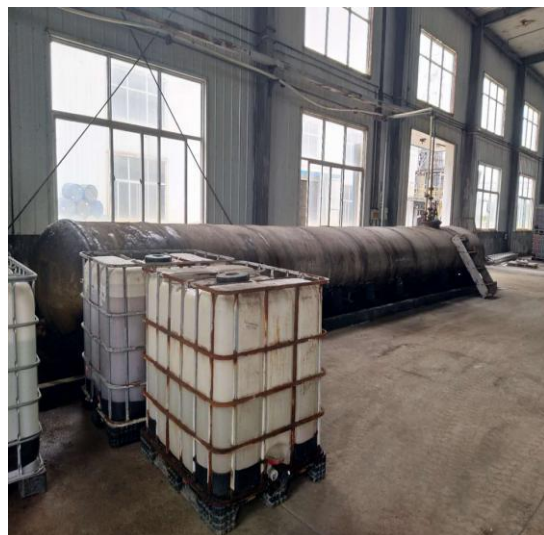
图 4-9 污水处理中和反应罐
