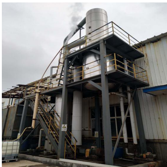
图 4-6 MVR 蒸发装置
