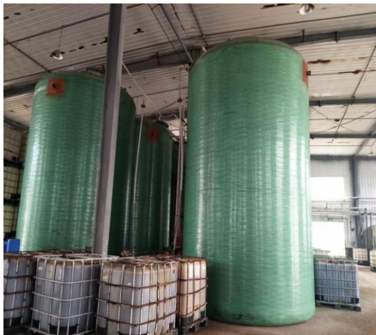
图 3-7 巯基乙酸钠贮罐
