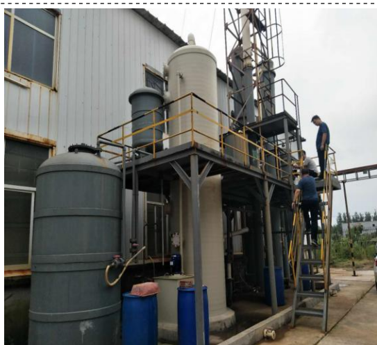
图 4-12 废气监测平台
