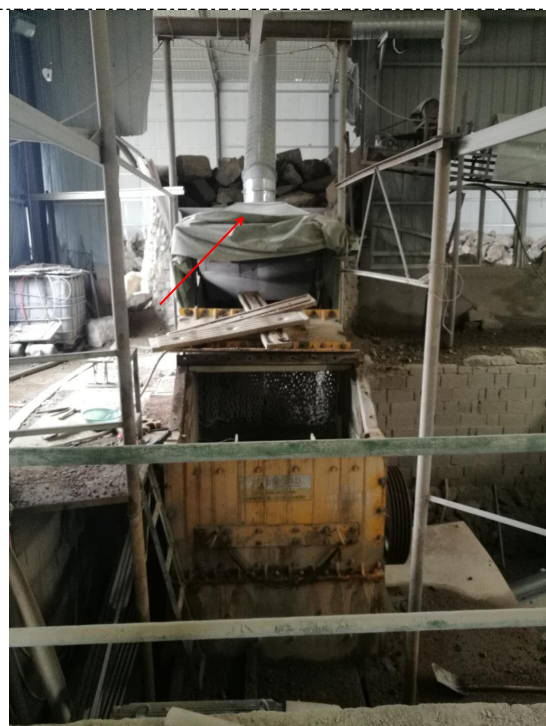
图 4-1 锤破废气收集系统
