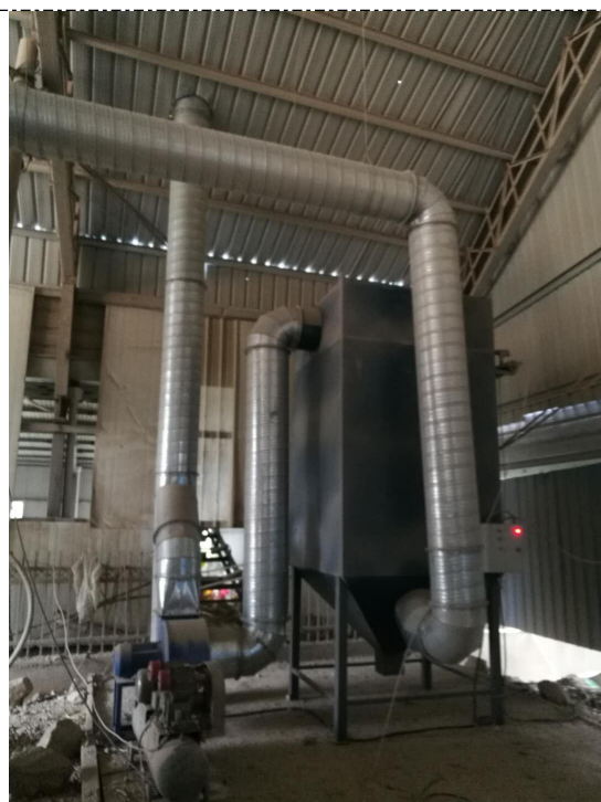
图 4-2 上料工序废气处理设施
