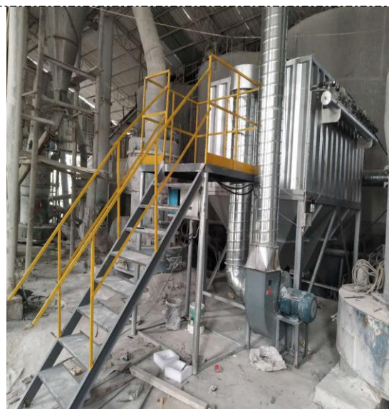
图 4-3 雷蒙机排气筒检测平台
