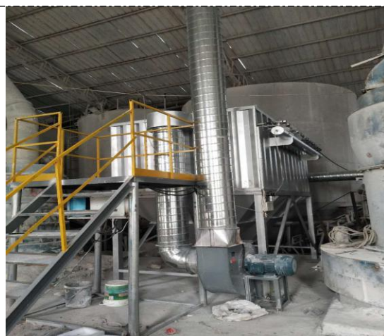
图 4-2 雷蒙机除尘器
