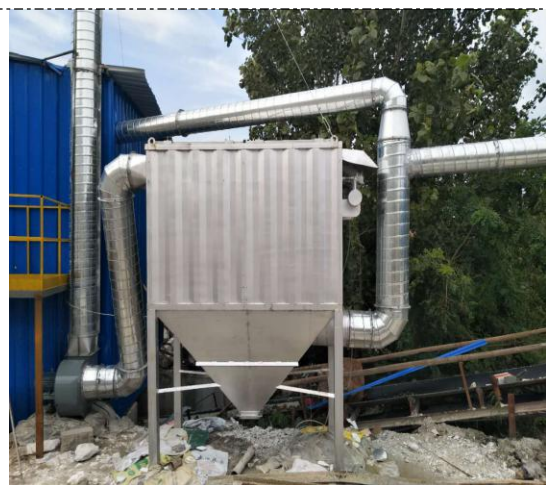
图 4-1 投料破碎除尘器
