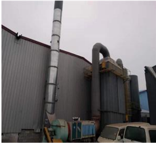
图 4-3 水喷淋+静电除尘+光催化氧化+活性炭吸附装置
