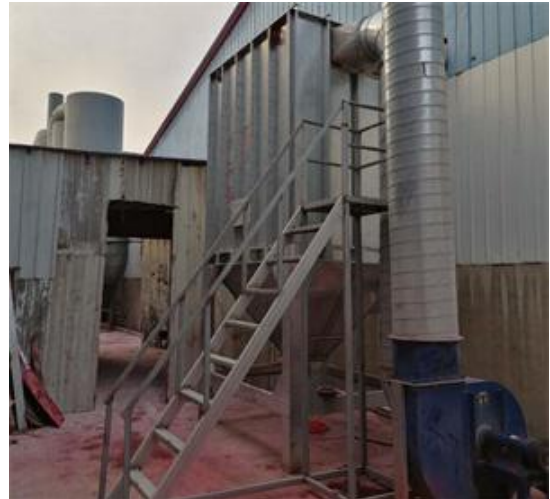
图 4-4 2#车间脉冲布袋除尘器
