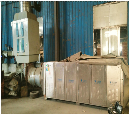
图 4-1 热压工序废气处理设施
