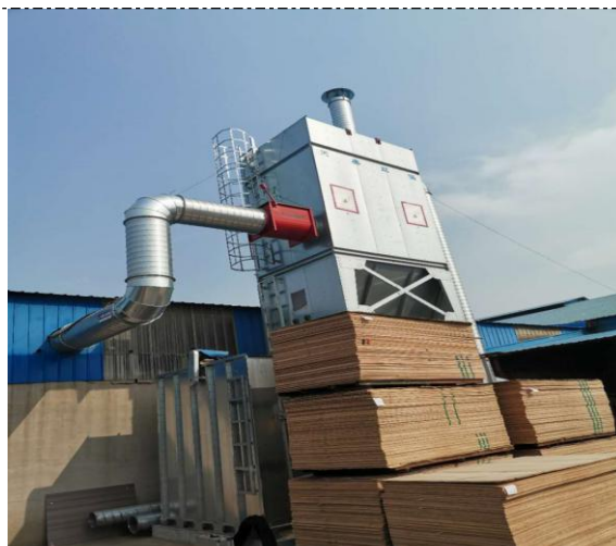
图 4-2 砂光工序脉冲布袋除尘器
