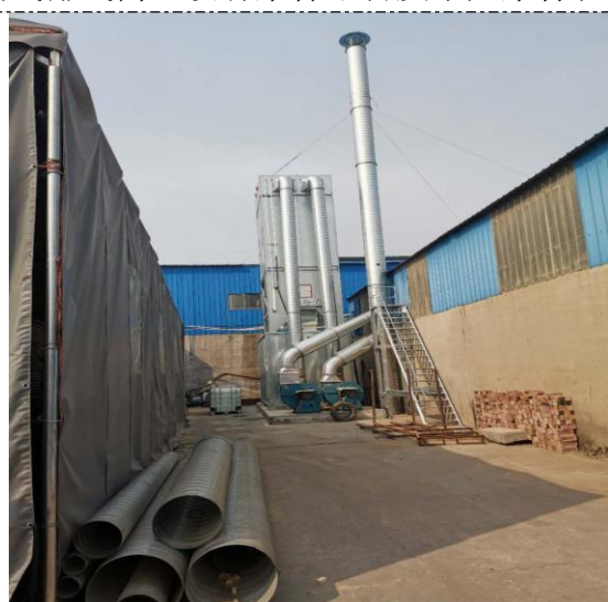
图 4-4 锯边工序排气筒及采样平台
