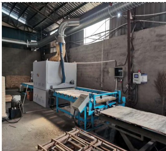
图 4-1 砂光工序废气收集管道
