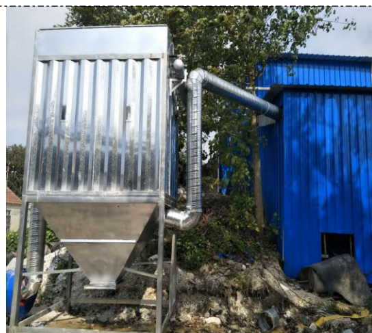
图 4-1 投料破碎除尘器
