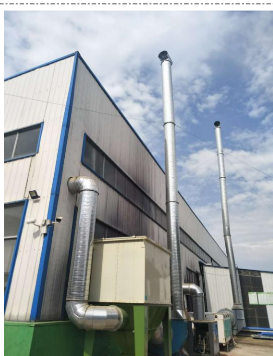
图 4-4 切割、焊接工序除尘器
