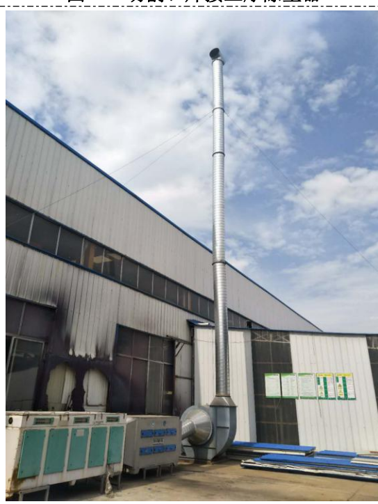
图 4-6 喷漆、烘干工序有机废气处理设施
