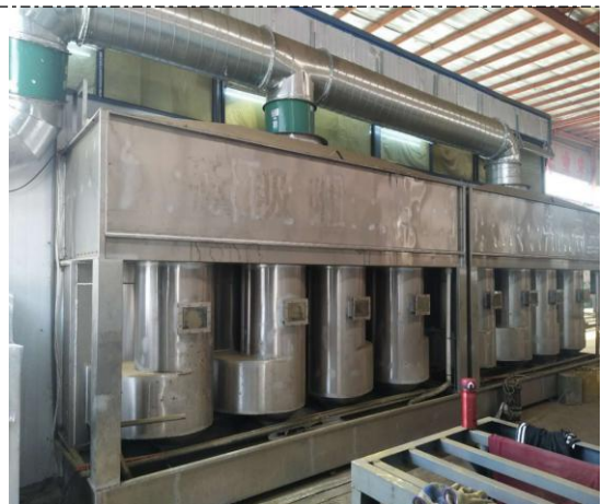
图 4-2 喷漆漆雾处理设施
