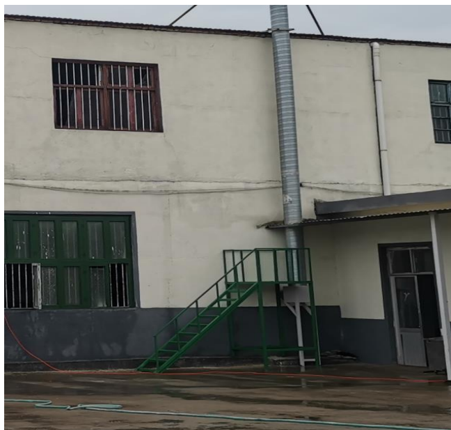
图 4-2 有组织废气排气筒检测平台
