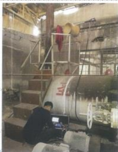
图 2 固定污染源天然气导热油锅炉现场采样
