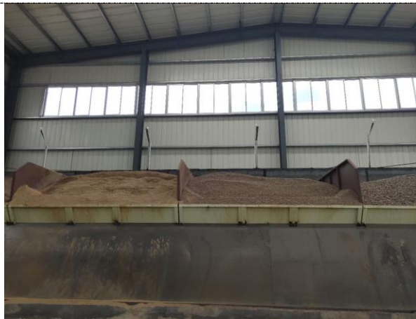
图 3 上料处水喷淋装置
