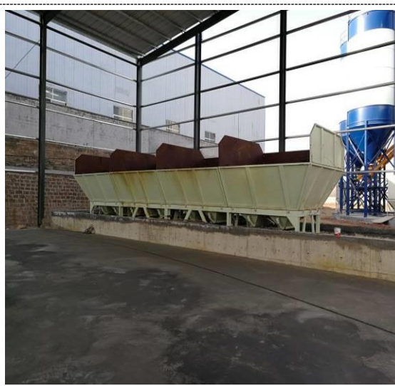
图 3-12 搅拌站上料口
