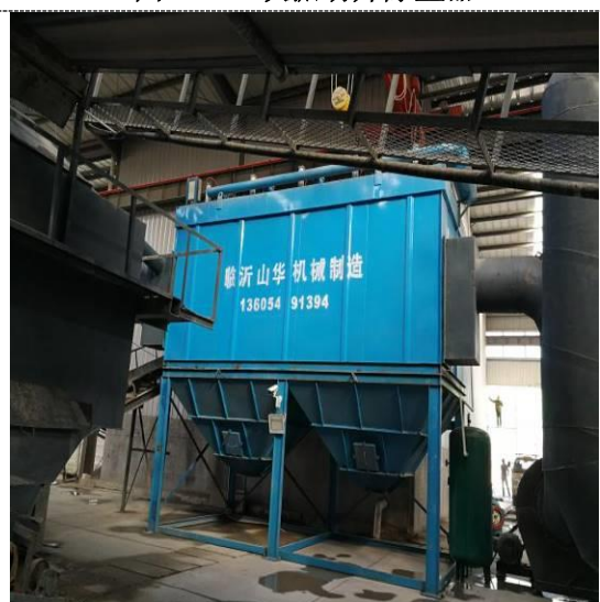
图 3-9 二次振动筛除尘器
