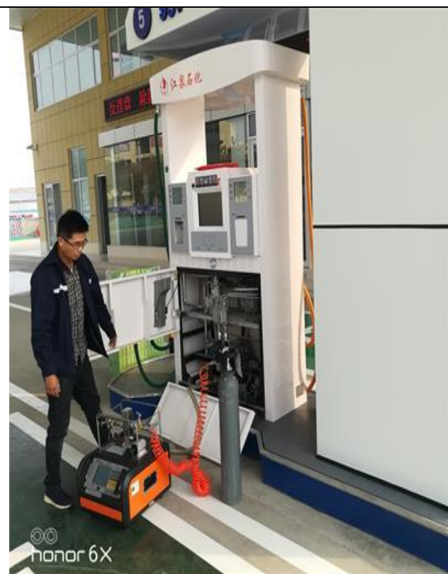
二级油气回收检测
