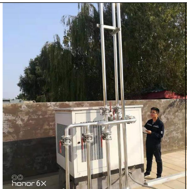
三级油气回收装置
