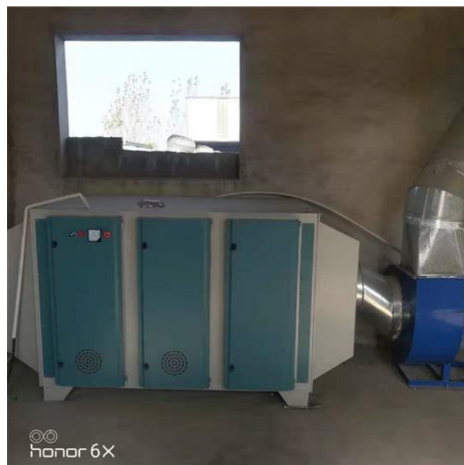
图 4-1 废气处理设施
