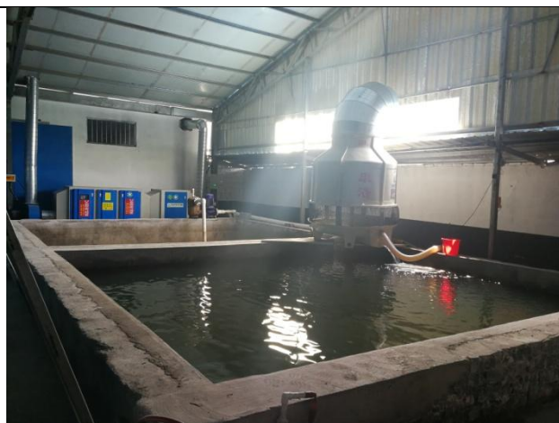
循环冷却水池
